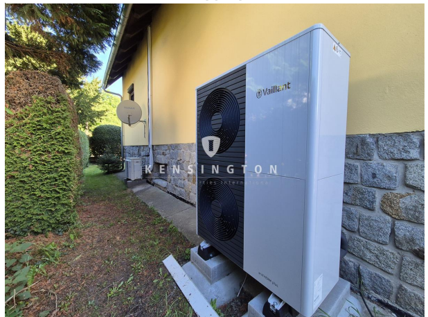
Wärmepumpe und Klimaaggregat
